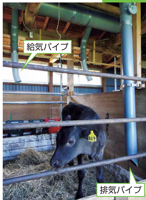
図 個別の子牛ペンに換気パイプを装着した状況
