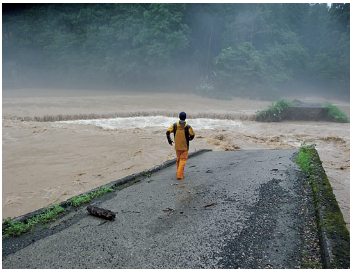
橋が崩落し道路が断たれた(約35m)
